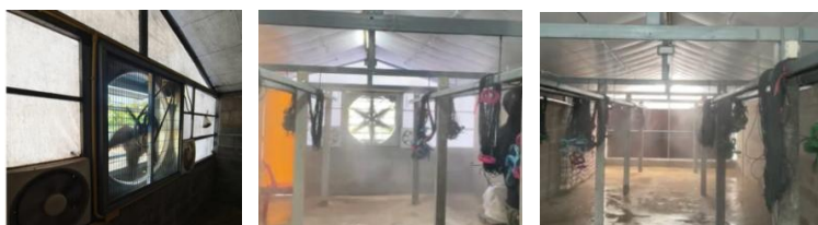
รูปที่ 5 ระบบระบายและรักษาคุณภาพอากาศในโรงเรือน
