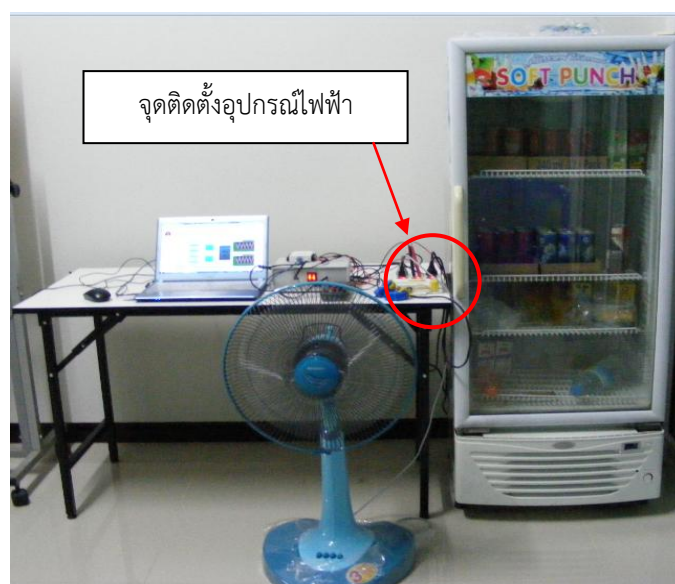
รูปที่ 4-2 การตรวจวัดปริมาณการใช้ไฟฟ้าและคุณภาพไฟฟ้า ณ จุดติดตั้ง ในสภาวะปกติ
