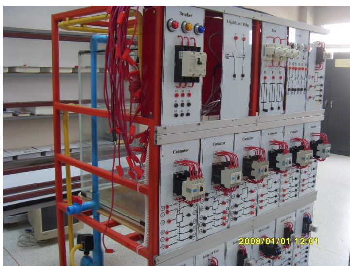
ภาพที่ 3.6 แสดงระบบควบคุมและเครื่องมือวัดทางไฟฟ้า
