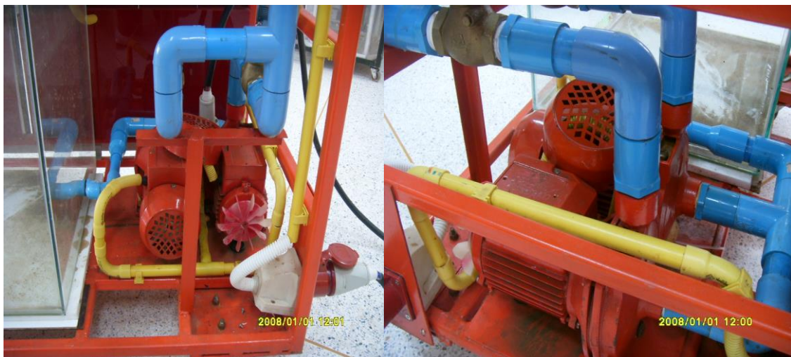
ภาพที่ 4.4 ระบบมอเตอร์และปั้มน้ำ และท่อส่งน้ำ
