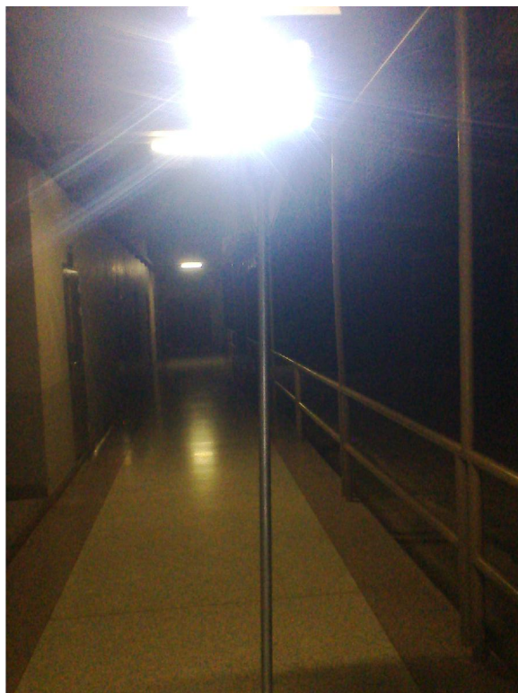
ภาพที่ 4.3 แสดงการทดสอบการจ่ายพลังงานไฟฟ้าให้กับโหลดของแบตเตอรี่
