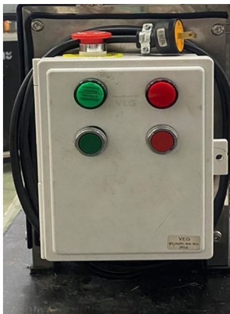
ภาพที่ 4-4 แสดงกล่องควบคุมวงจรไฟฟ้า
