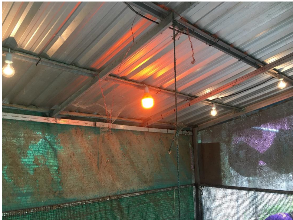
รูปที่ 4.14 กล่องควบคุมและทดสอบการทำงานของระบบในการจ่ายหลอดไฟ
