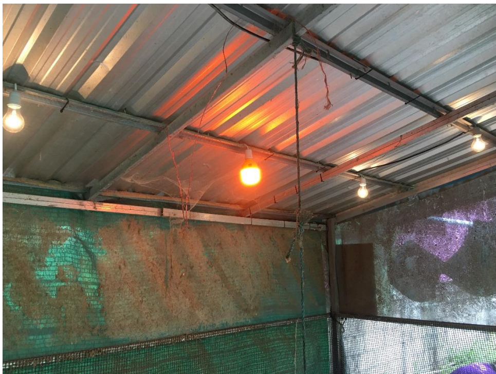
ภาพที่ 4.17 กล่องควบคุมและทดสอบการทำงานของระบบในการจ่ายหลอดไฟ
