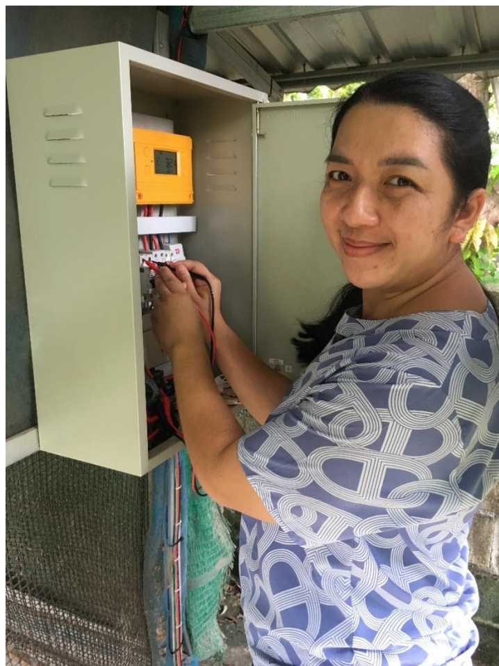
ภาพที่ 4.16 ตรวจสอบการทำงานของระบบ
