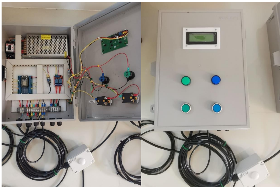
(ก) ภายในกล่องควบคุม
