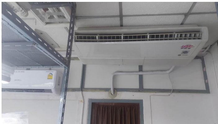
เครื่องปรับอากาศ (Air Conditioner) ใช้สำหรับควบคุมอุณหภูมิภายในห้องเพาะเลี้ยง โดยทั่วไป จะควบคุมอุณหภูมิที่ประมาณ 25+2 องศาเซลเซียส
