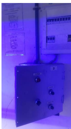
เครื่องควบคุมเวลา (Timer) ใช้ควบคุม การเปิด-ปิดไฟ
