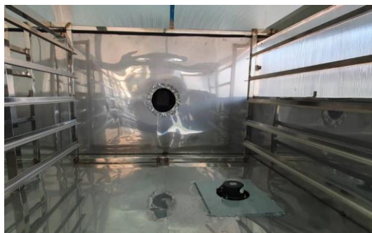
รูปที่ 4-3 แผงกระจายอุณหภูมิและพัดลมระบายอากาศ
