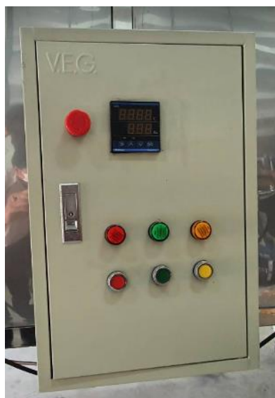
ภาพตู้ควบคุมการทำงานและไฟบอกสถานะ
