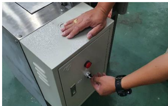
ขั้นตอนที่ 4 : เปิดระบบการทำงานที่ตู้ควบคุม
