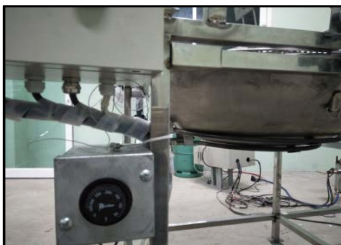
ภาพที่ 4-11 ภาพถ่ายชุดควบคุมอุณหภูมิ
