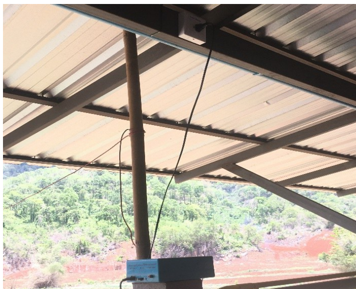
รูปที่ 4.22 การทดสอบจ่ายและการทำงานของระบบไฟรั้ว
