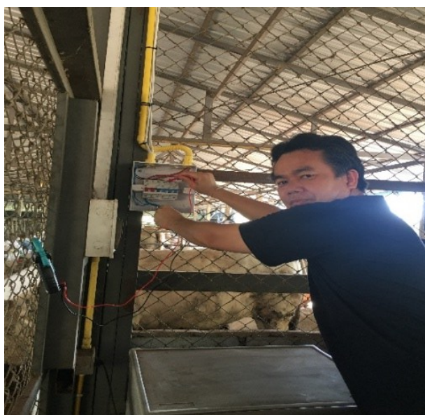
รูปที่ 4.14 การทดสอบระดับแรงดันระบบก่อนจ่ายไปยังโหลดในระบบ
