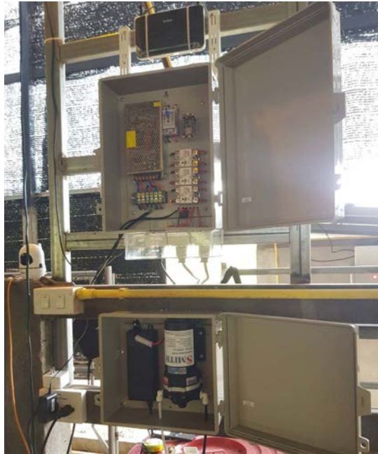
รูปที่ 3-36 การติดตั้งตู้ควบคุมของระบบ ตู้ควบคุมปั๊มพ่นหมอก เราเตอร์ และกล่องวงจรปิด
