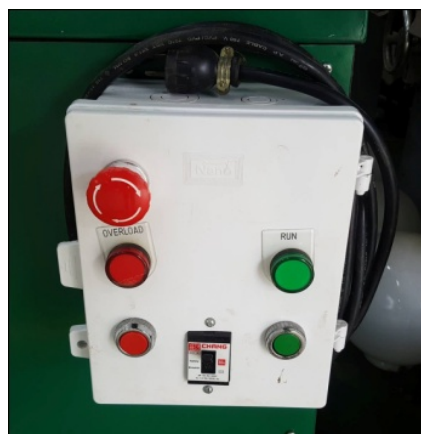
รูปที่ 3-13 รูปถ่ายชุดสวิตช์ควบคุม
