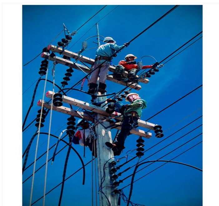
ภาพที่ 2.6 อันตรายที่อาจเกิดจากไฟฟ้า ที่มา (จิตสำนึกความปลอดภัย, 14 กุมภาพันธ์ 2559)
