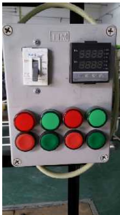
รูปที่ 3.8 แผงควบคุมอัตโนมัติ
