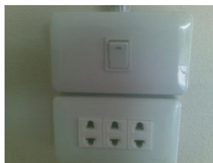
รูปที่ 4.3 ปิดสวิตช์ให้หลอดฟลูออโรแอลอีดีหยุดทำงาน
